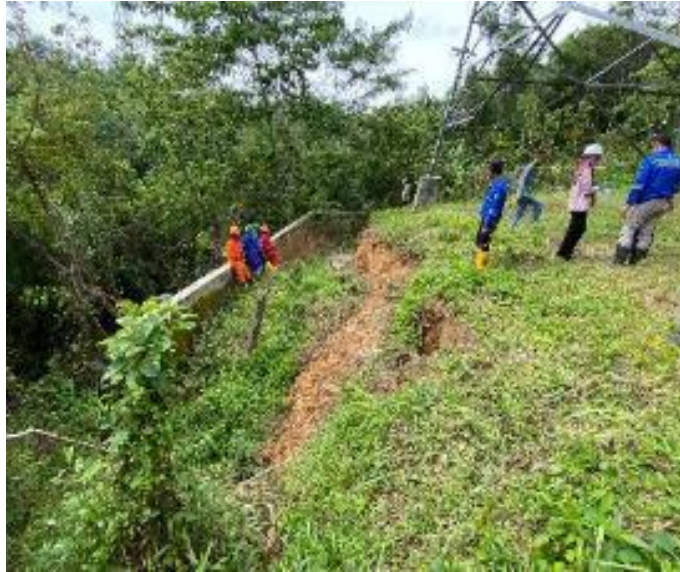
Gambar 1.2 Kondisi Dinding Penahan Tanah yang Mengalami Pergeseran
