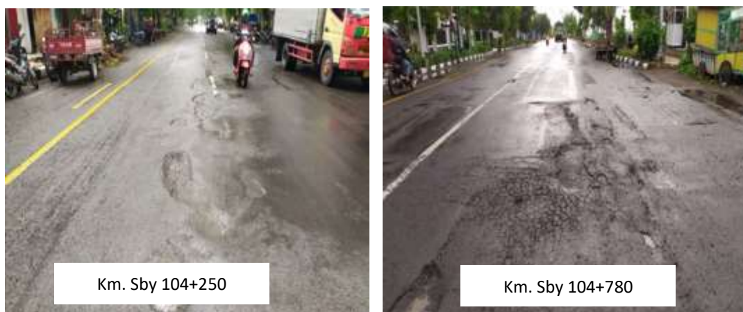
Gambar 2 Gambar Kerusakan Jalan Panglima Sudirman Kabupaten Tuban, Jawa Timur
